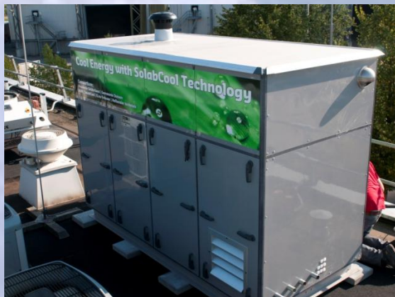
Gebouwkoeling met eigen restwarmte hoofdkantoor AVR
